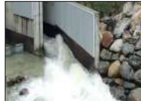
Kleinwasserkraft- werk in Fiesch - Energie der Zukunft
